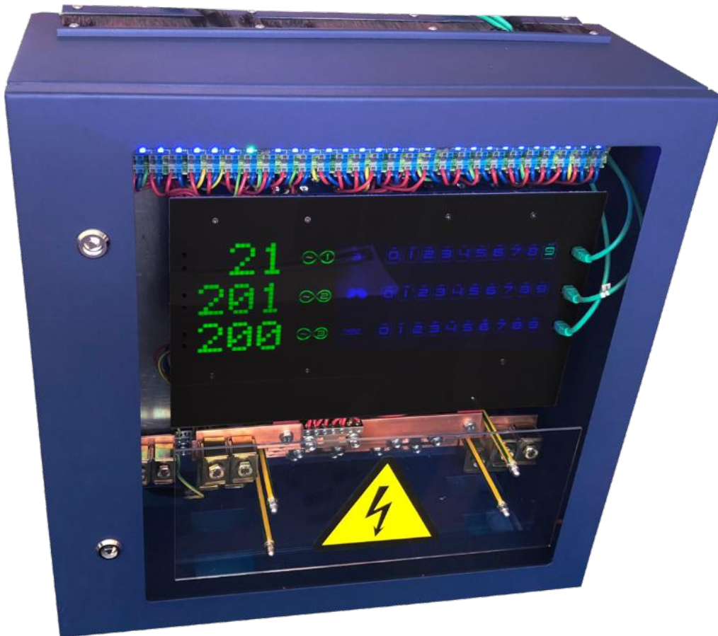
Рисунок 2.3.20. RPCM 3x250 в безопасном состоянии с закрытой дверцей.
