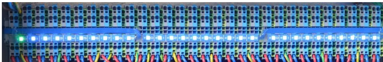
Рисунок 2.3.12. Верхняя панель с клеммами выводов на примере RPCM 3x250
